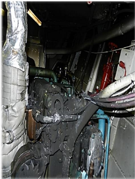
Motoren fikk så omfattende skader i brannen at den må skiftes ut. Foto: Tromstrygd/Torbjørn Lorentzen.
